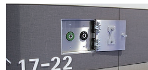
病棟の廊下や部屋の一部には、酸素を出す口があります。
