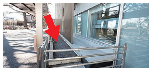
外来診療棟は免震のため建物と周囲の地面の間に隙間や砂利があります。
